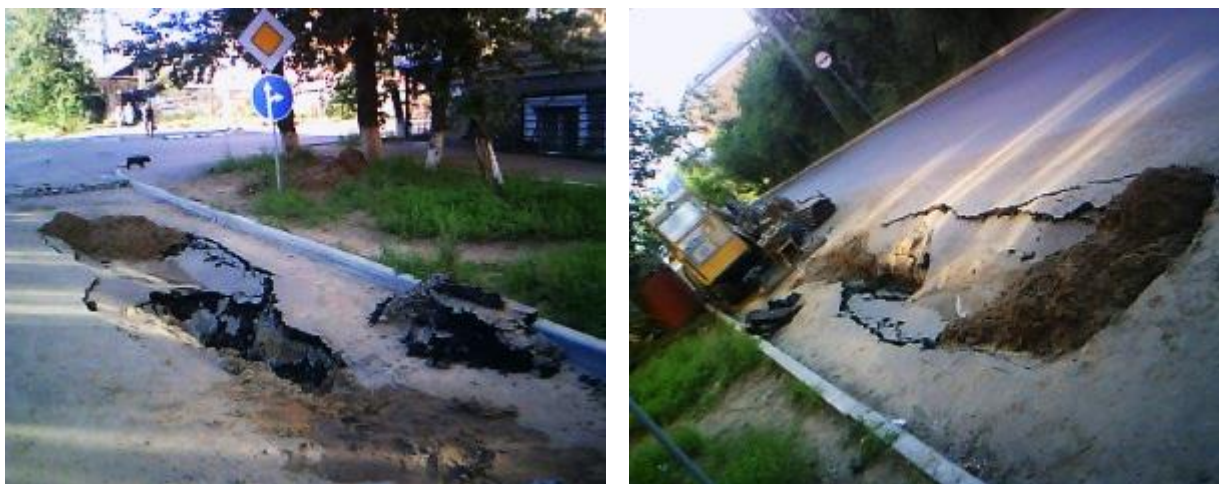
Рис. 1. Місця провалів після проведення ГНБ
