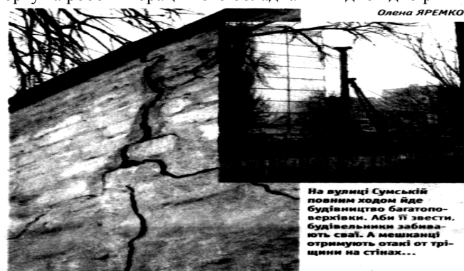
Рис. 2. Наслідки проявів екологічної небезпеки під впливом техногенних землетрусів (забиття паль при будівництві будинку)
